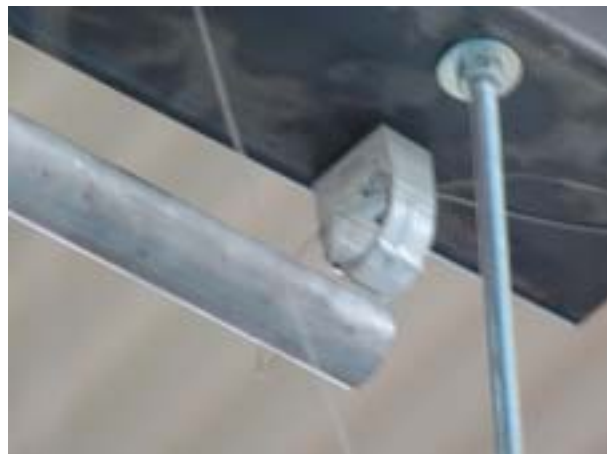
電線管が CLIC から外れた状態
